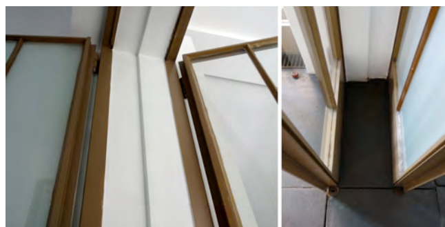
図 12) ホールと食堂をつなぐ二重ドア詳細。上記の二重ドアは前後で寸法が異なる。寸法の差異は二重ドアの間で調整されている。
