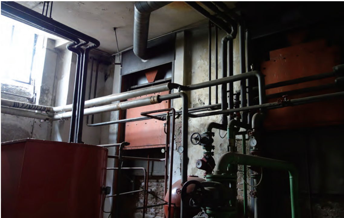
図49) ストンボロー邸の地下に設置された巨大装置。この装置は、居間の真下に位置している。奥にはカウンターウェイトでせり上がる鉄製のシャッターが組み込まれている。
