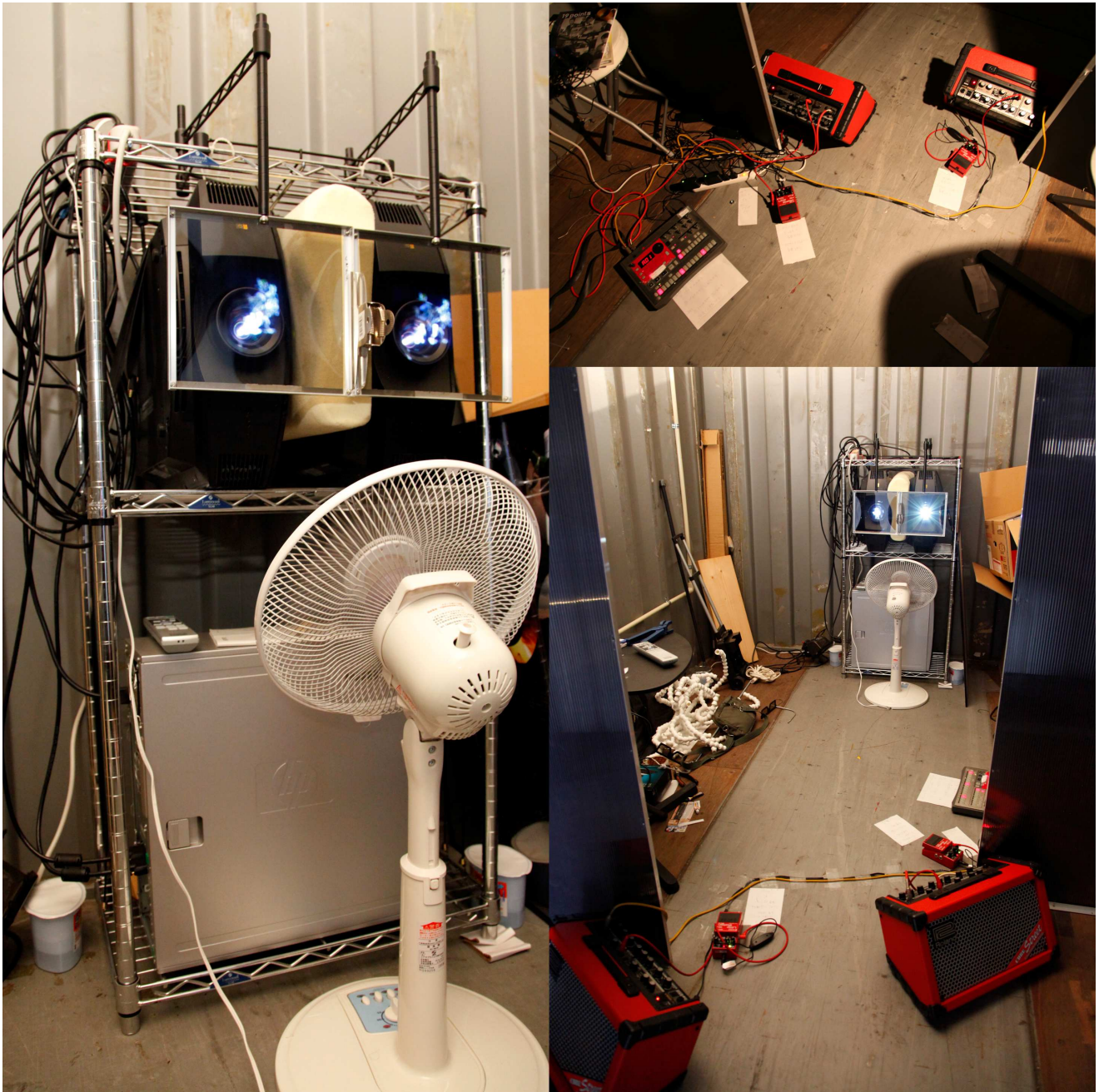
写真 4 2機の縦置きプロジェクターを設置したラック（左）手前の額に収まっているのが偏光フィルター。右は、主に音響装置。たまたま、赤色の製品で揃っている。
