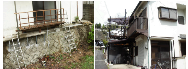
写真1 付加されたデッキ 写真2 パイプ構造のベランダ
